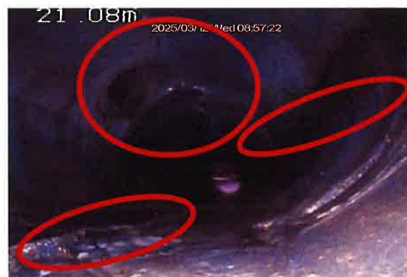
Figure 4: Fissures et débordement
