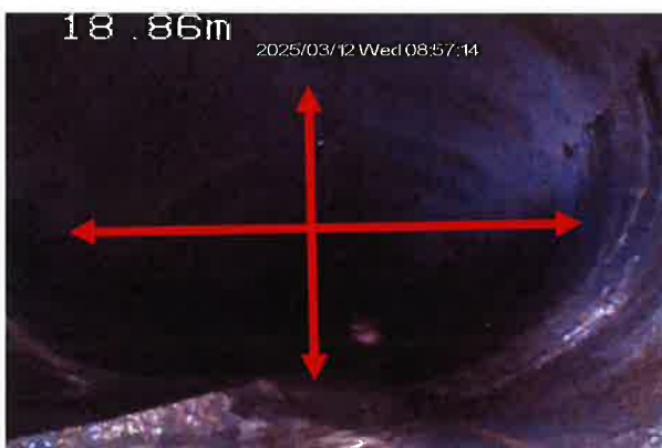
Figure 3: Ovalisation de la conduite
